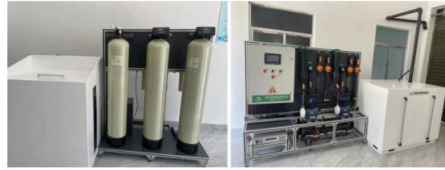
次氯酸钠发生器现场设备
