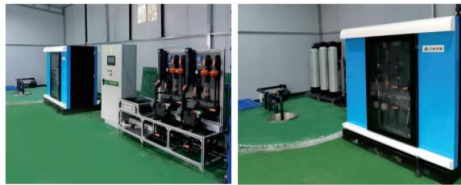
祁东2公斤次氯酸钠现场设备
